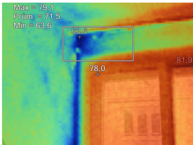
Obr.2 Pohled na detail nad levým rohem okna.
